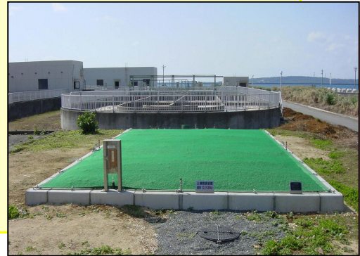
(下水道処理施設での設置例)
